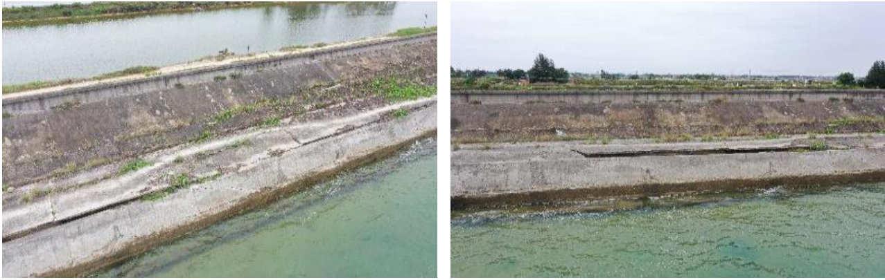
图 3.7-20 南三联围海堤破损、开裂堤段
