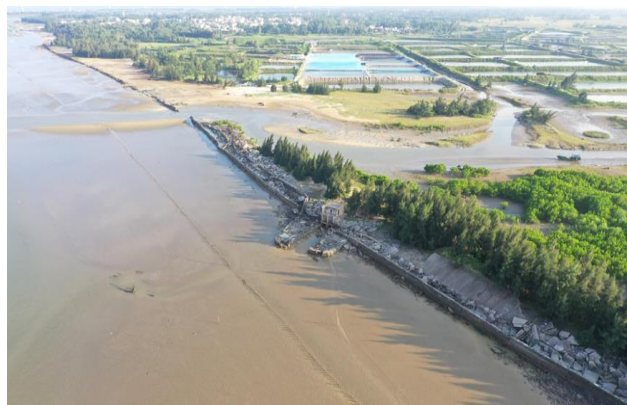
图 3.7-5 严重损毁的调南海堤
