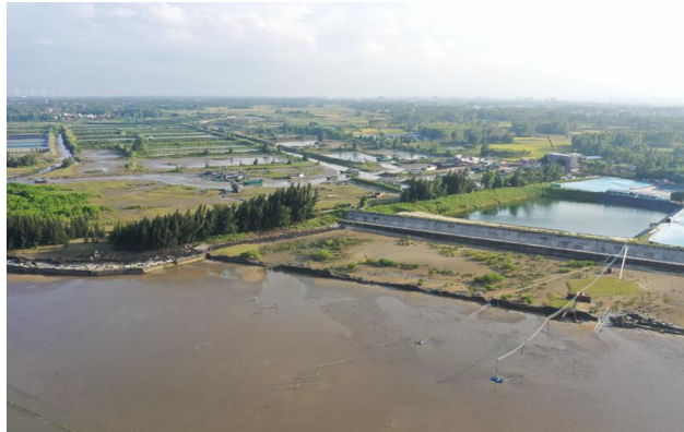
图 3.7-8 雷州调南海堤存在缺口
