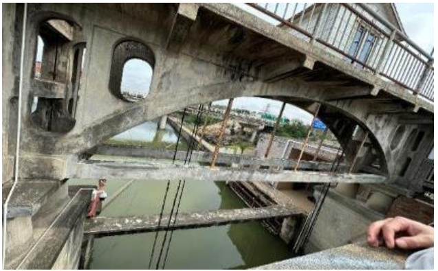
图 3.7-14 塘尾分洪闸钢筋锈蚀
