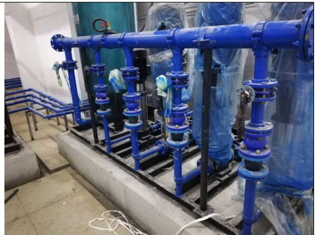
图7-12水泵减震措施
