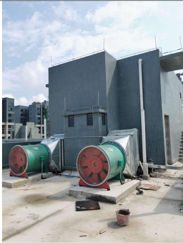
图7-9 楼顶商业烟道
