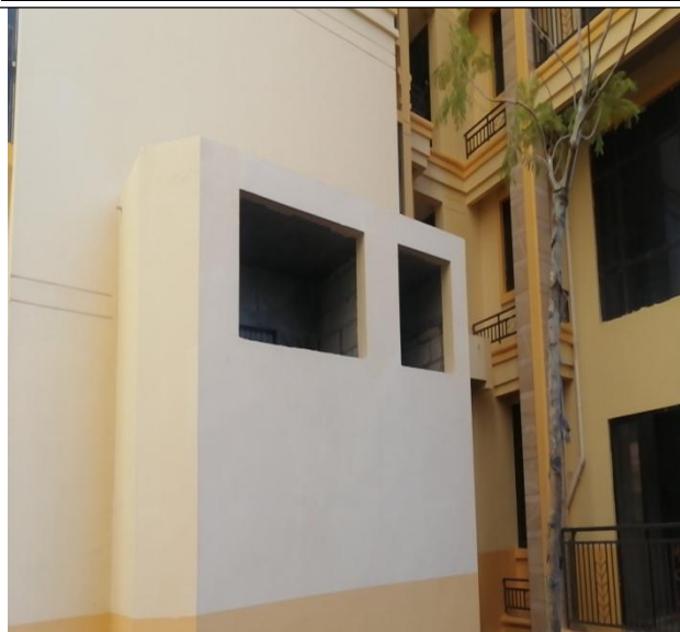
图7-9 项目地下室换气口
