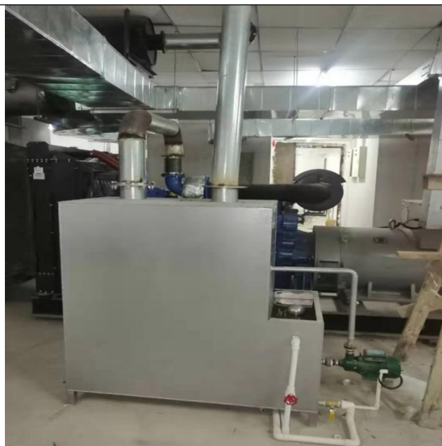
图7-11 备用发电机废气处理装置
