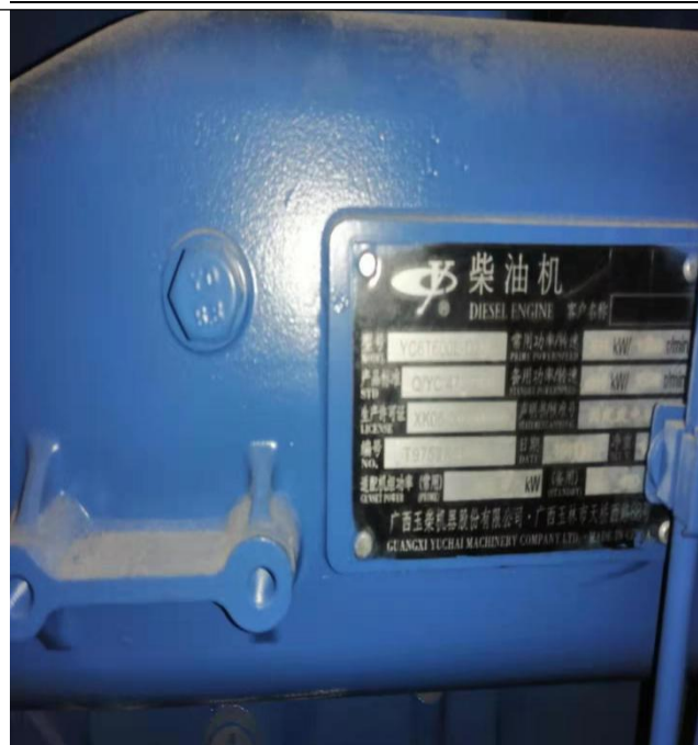
图7-13 备用发电机铭牌（350kw）
