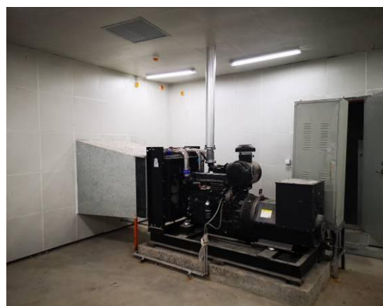
备用发电机房内的隔音棉
