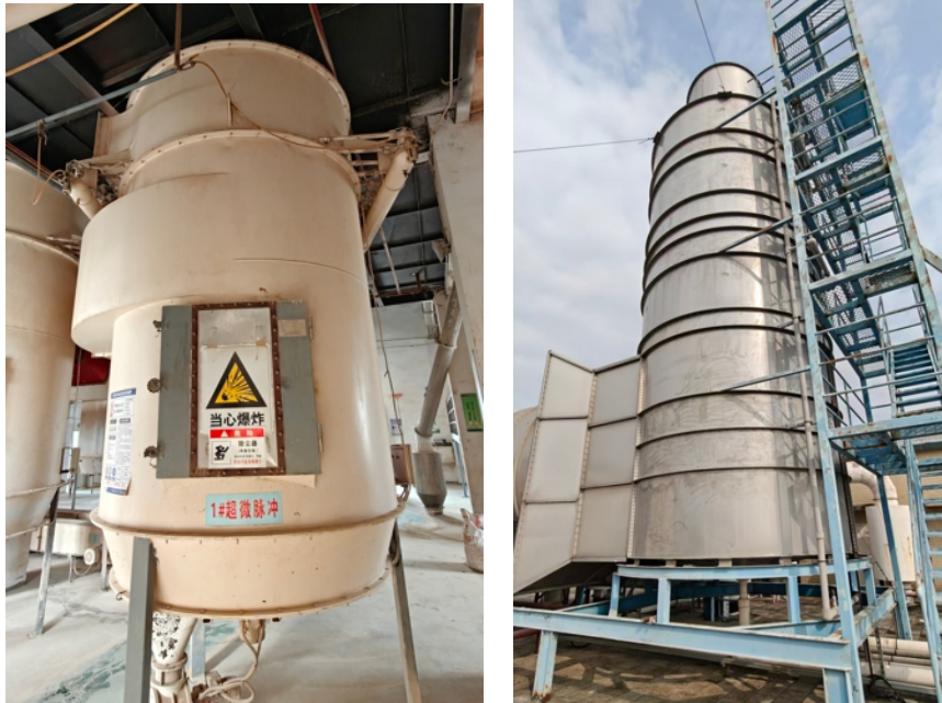
图 2.11.8-1 现有脉冲除尘器（左）、喷淋塔（右）
