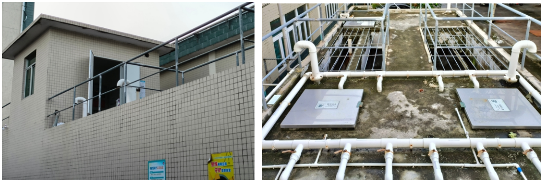
图 2.11.8-2 喷淋水污水处理站
