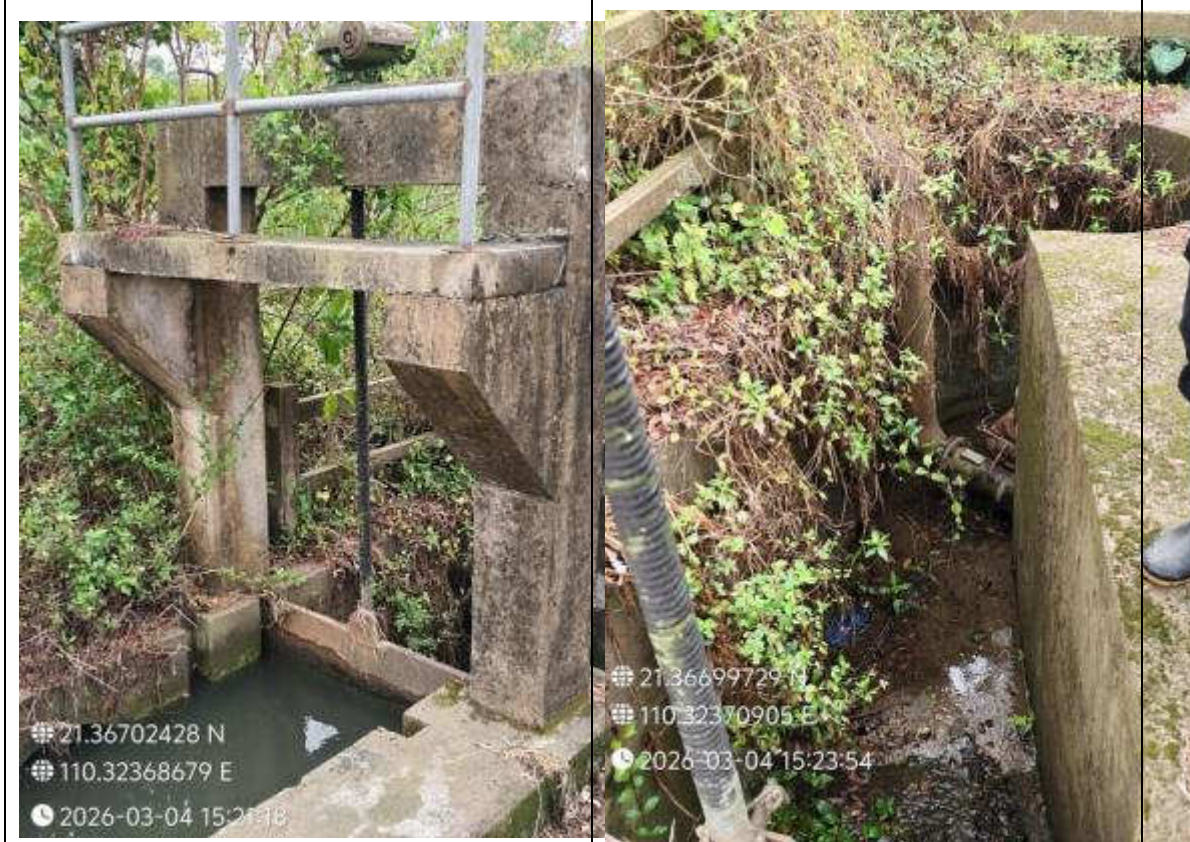
华封支渠节制闸结构老化，启闭困难
