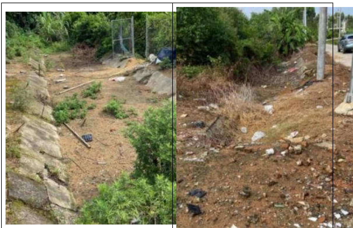
黄略干渠防渗面板破损、渠道淤积
