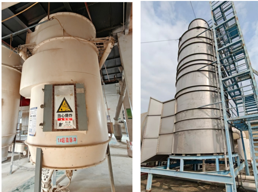
图 2.11.8-1 现有脉冲除尘器（左）、喷淋塔（右）
