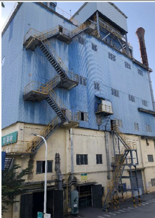
现有煤磨系统除尘器
