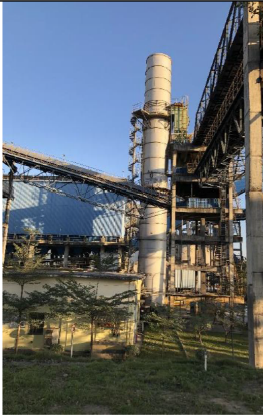
现有窑头除尘器
