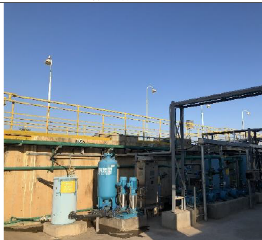
现有工业废水处理站（泵机）
