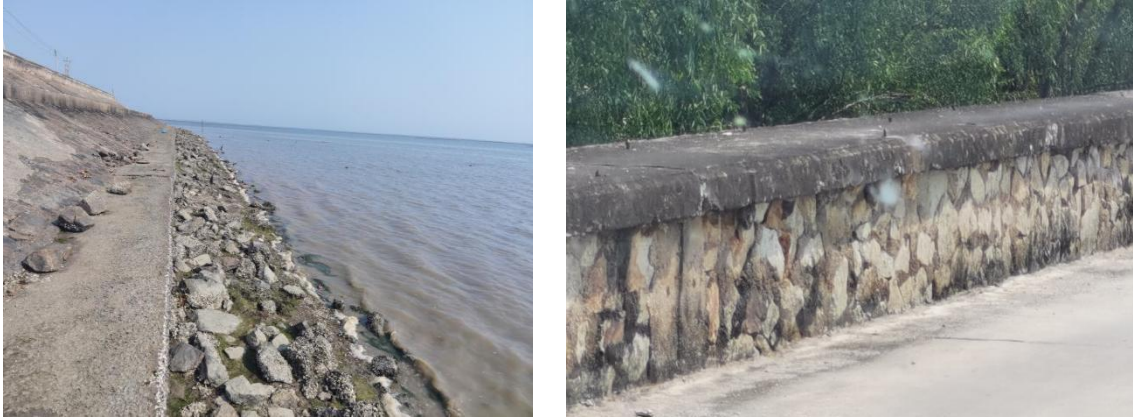
图 2.2.1-1 现状堤顶防浪墙局部破损、堤脚
