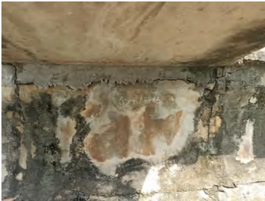
图 2.5.1-7 穿堤涵洞外观质量缺陷图
