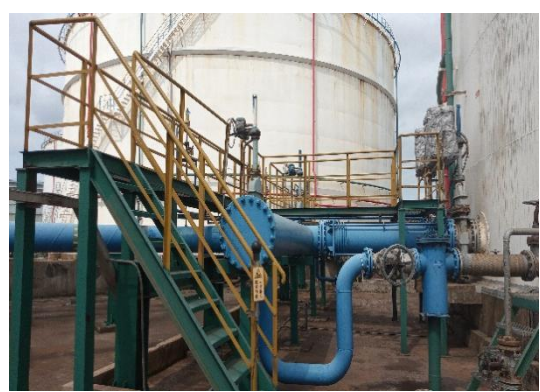
罐区内装卸管道
