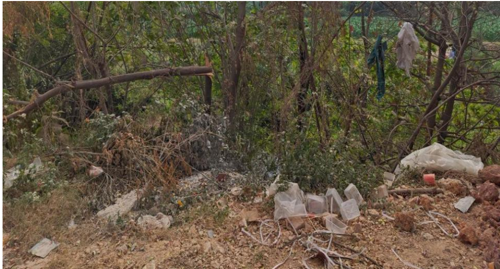
图 3-14 背水坡灌木丛生、散落生活垃圾
