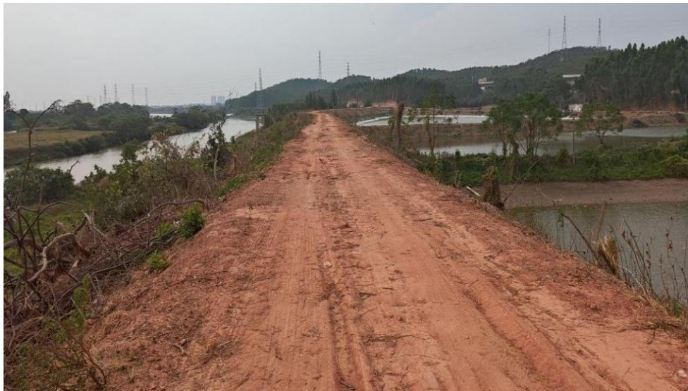
图 3-20 K3+870 滑坡段堤顶
