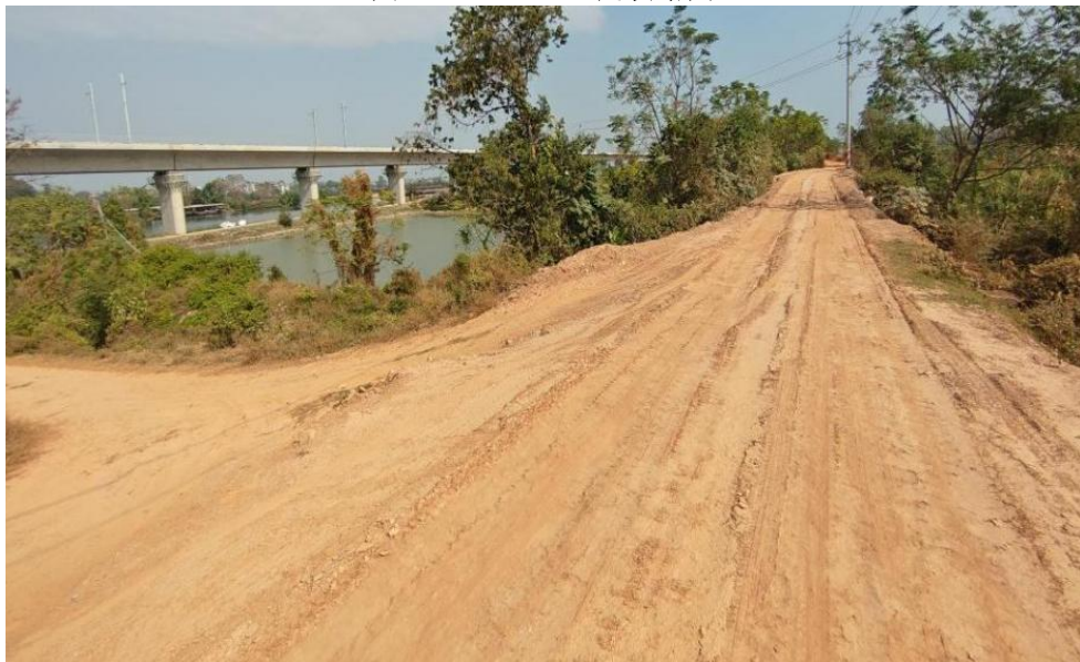
图 3-9 K1+170 堤坝矮小、土路面
