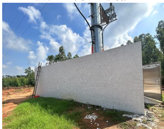
照片 15 电缆终端围墙现状
