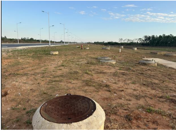
万象中路雨水管道
