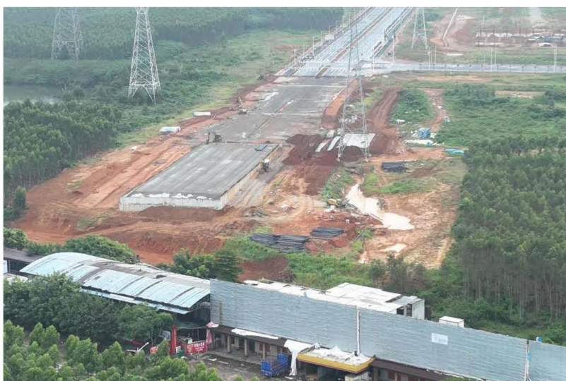
图 4 施工范围内拦挡防护工作不到位
