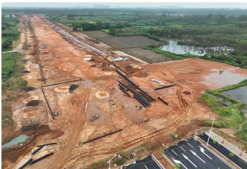
图 3 大面积地表及边坡裸露现状
