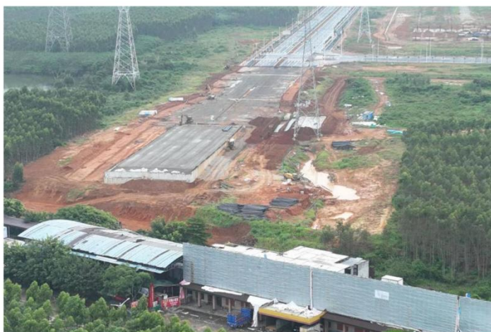
图 4 施工范围内拦挡防护工作不到位
