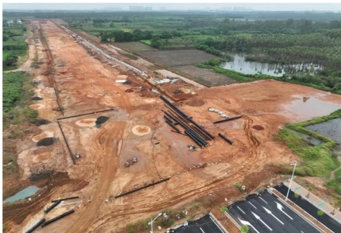
图 3 大面积地表及边坡裸露现状
