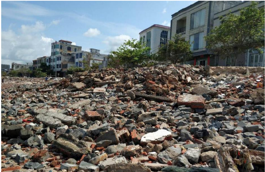
图 2.1.2-1 企水港原有堤岸崩塌情况近景
