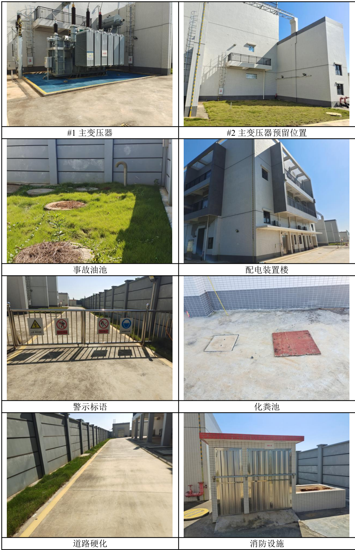
图 2-3 110kV 北和站现状照片
