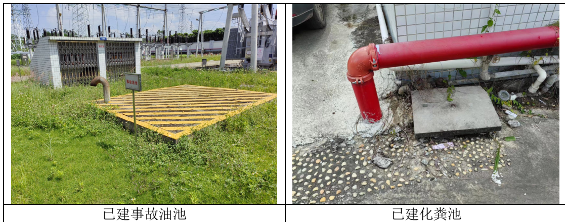
图 2 工程站内环保设施现状
