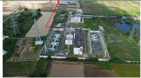
220kV 吴川站现状
