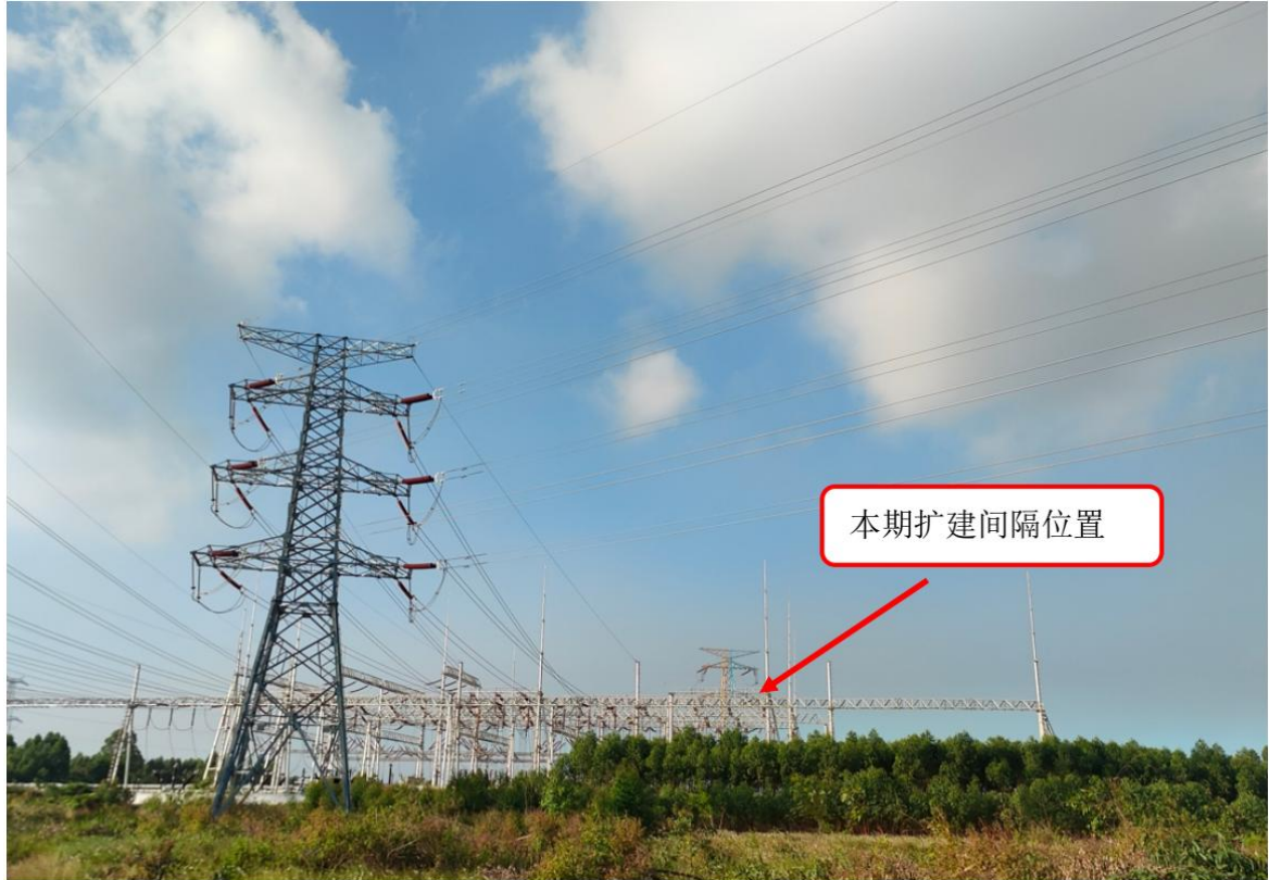
图 2-5a 500kV 东海岛变 220kV 出线构架现场照片
