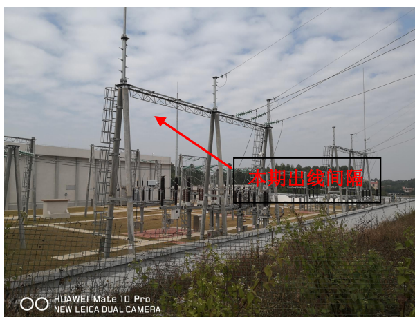
图 2-1 110kV 高桥站出线间隔情况
