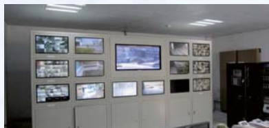
安全防范用闭路电视监控
