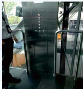
电梯无障碍设施
