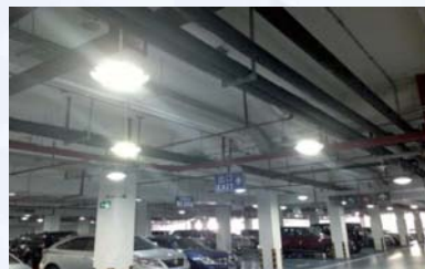
PV-LED照明系统(车库)
