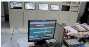
建筑设备自动化管理监控
