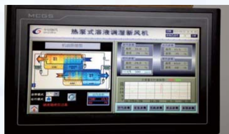
新风机组控制面板
