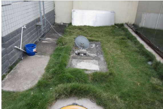
变电站内化粪池
